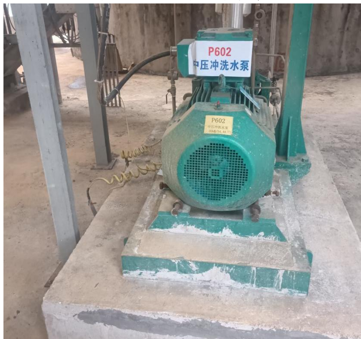
图 4.1-14 中压冲洗水泵
