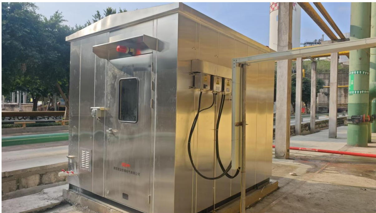
图 4.1-3 一化、二化循环冷却水排放口在线监测房
