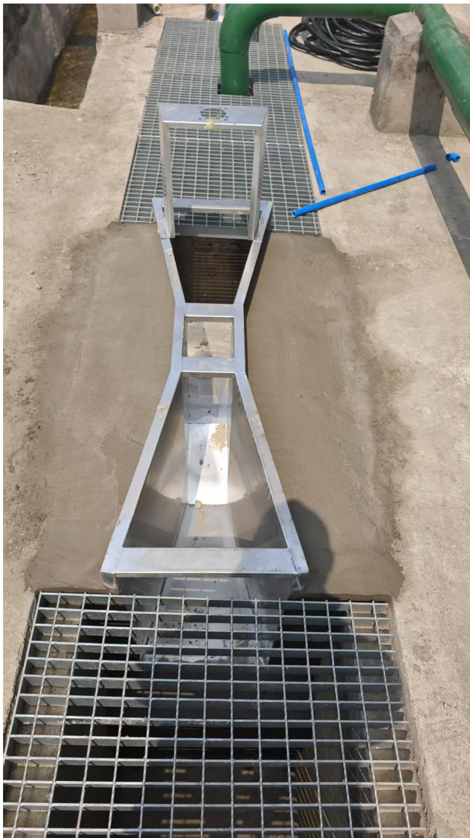
图 4.1-4 一化、二化循环冷却水排放口
