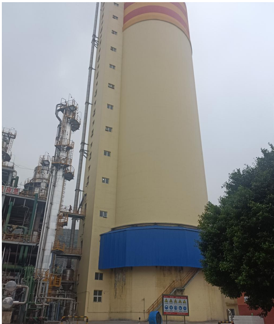
图 4.1-7 一化造粒废气排放口 DA010
