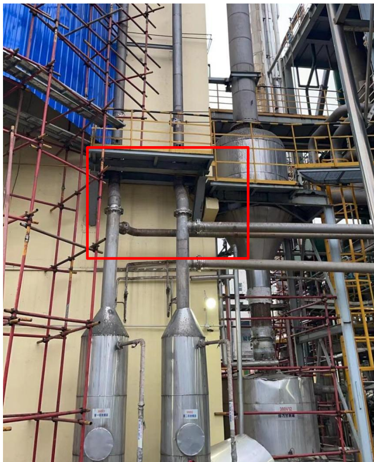
图 4.1-8 一化中间缓冲罐废气排放口 DA029 采样口及采样平台
