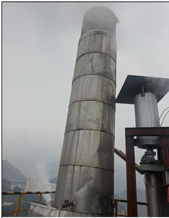
图 4.1-9 二化常压吸收塔废气、二化 4 巴吸收塔废气排气筒（DA009、DA005）
