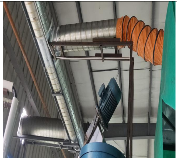
注塑废气管道
