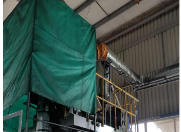
吹塑机废气管道
