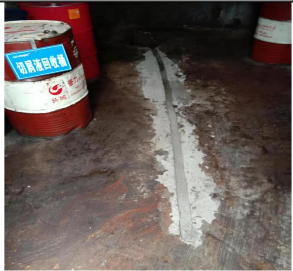
危废间引流槽
