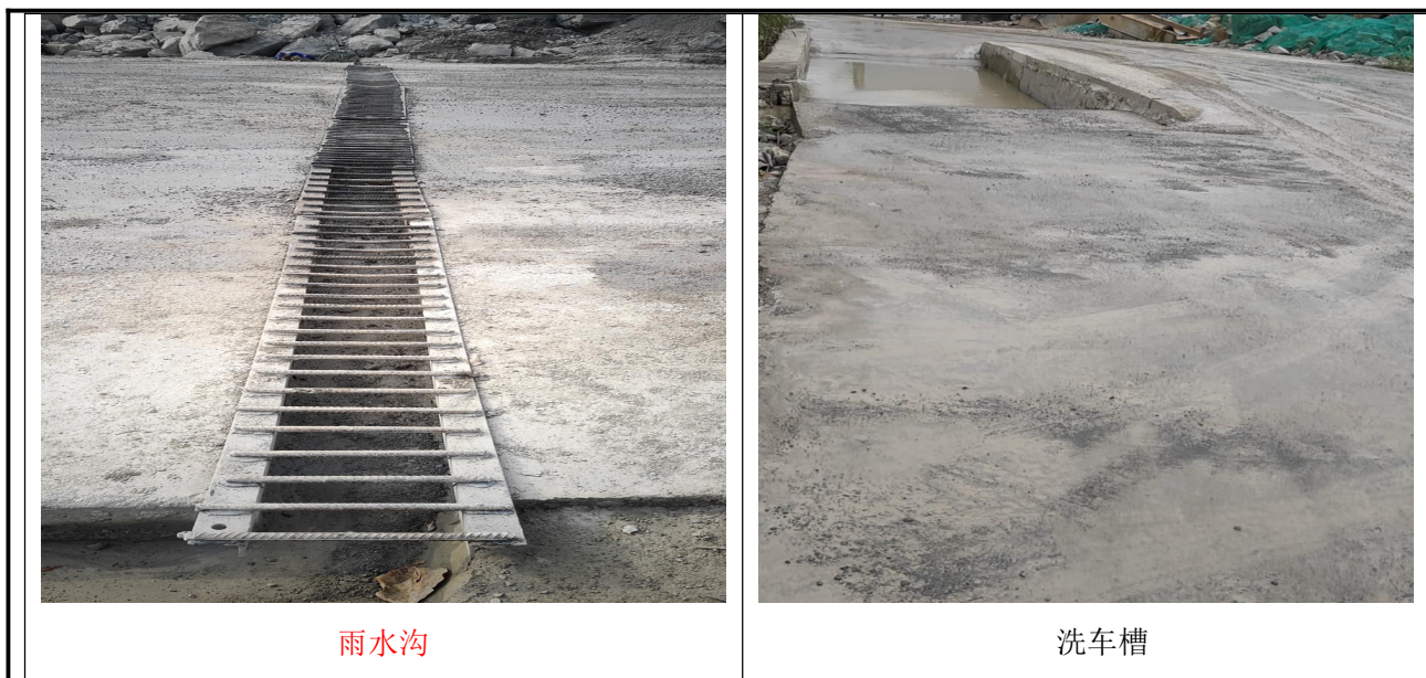
图 3.1 废水处理设施图
