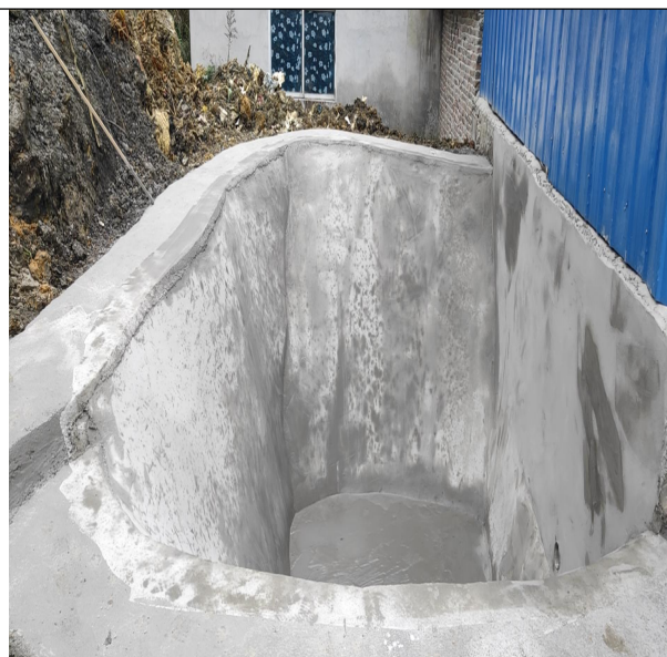
柴油罐应急池
